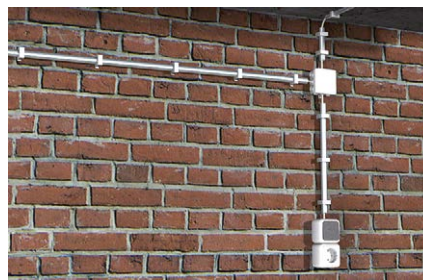
Fissaggio di cavi
